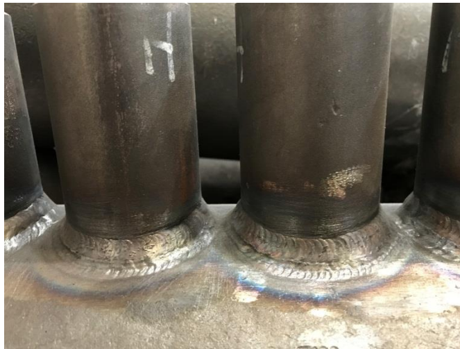
Slika 4 Konkavan zavareni spoj priključka i sabirne komore
