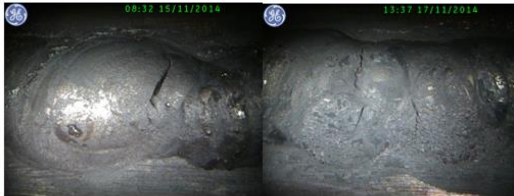
Slika 5 Pukotine u završenom krateru
