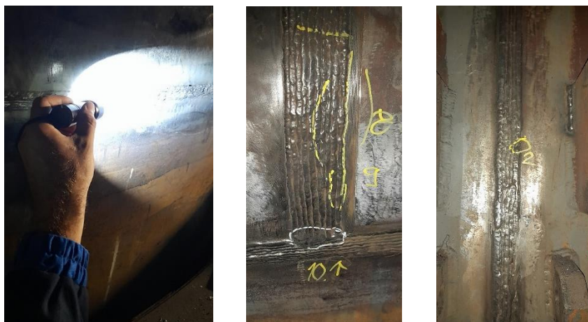
Slika 11. Vizuelno ispitivanje zavarenog spoja
